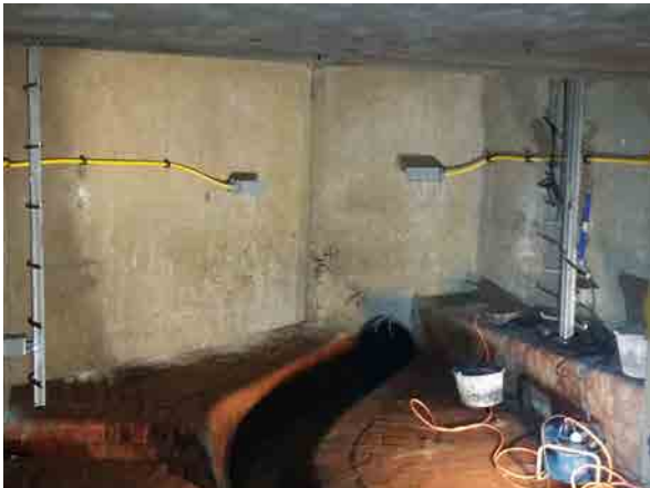
Abb. 2 Im Schacht auf der Südseite des Staukanals: Messendpunkte als als Messschnecken für eine hochgenaue Höhenmessung
